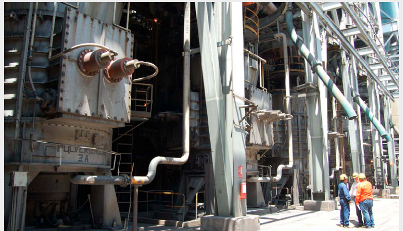
Actividad técnica de RKB sobre el terreno en una central eléctrica
